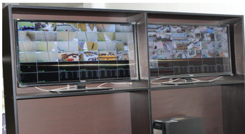
PANELES DE CONTROL.
