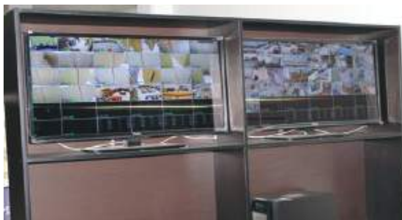
PANELES DE CONTROL.
