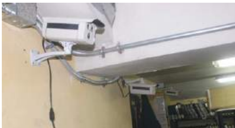
CÁMARA DE SEGURIDAD.
